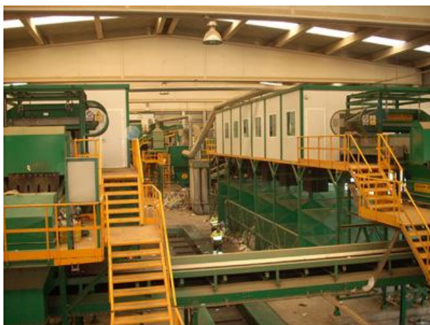
Vista general de instalaciones de tratamiento de RSU
